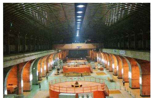
インドネシア水力発電所
