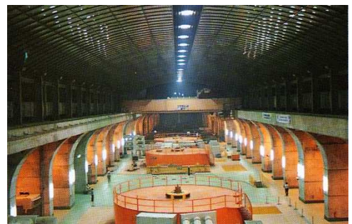
インドネシア水力発電所
